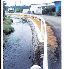
南小畦川沿い 路肩崩壊(芦荻場)
